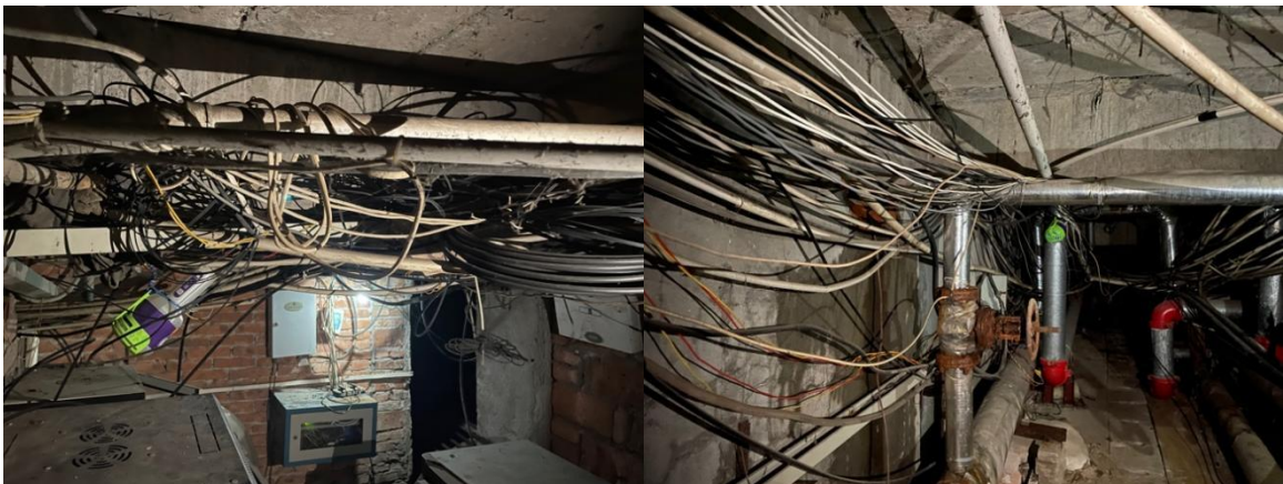
图 2-2 线路多年老化且布设杂乱无章存在消防安全隐患
