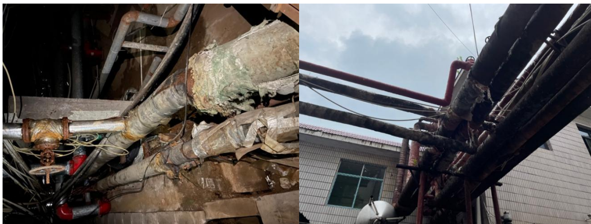
图 2-3 管道锈蚀严重且爆管多次存在较大安全隐患
